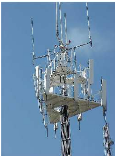
Figura 3.7: Imagen de una torre con antenas de telefonía móvil. Obsérvese la división en sectores de 120°.
